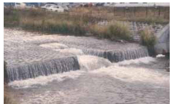
図10. 遡上魚が魚道の入り口を見付けやすいよう、「呼び水」を注ぐ構造の魚道が多いが、この場合は遡上水路の脇から水を落とすという簡単な構造でその効果を高めている（止別川の落差工に付設された魚道）。
