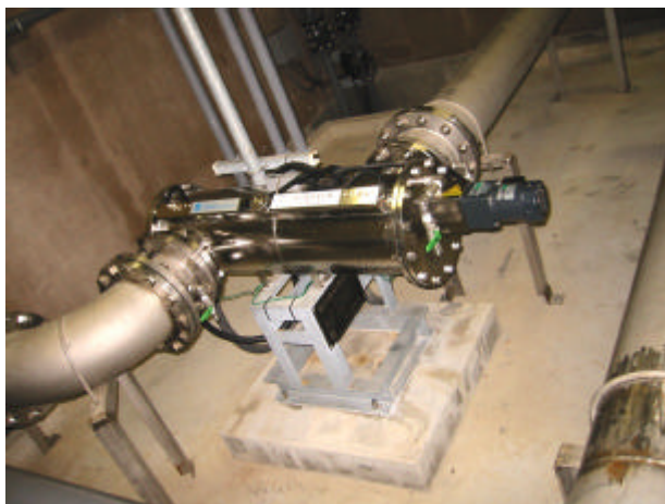
図4. さけ・ます資源管理センター尻別事業所に設置されている中圧紫外線殺菌装置。
